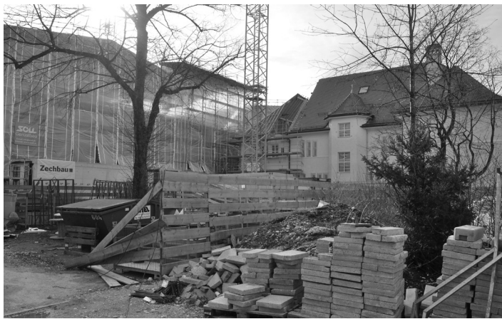
Unter einem großen Watterschutzdach entsteht derzeit an der Grandlstraße der Neubau der Realschule, der denkmalgeschützte Schulbau von 1912 wird zeitgleich saniert. Die Inbetriebnahme ist für Anfang 2020 vorgesehen. Foto: Frieder Vogelsgesang
