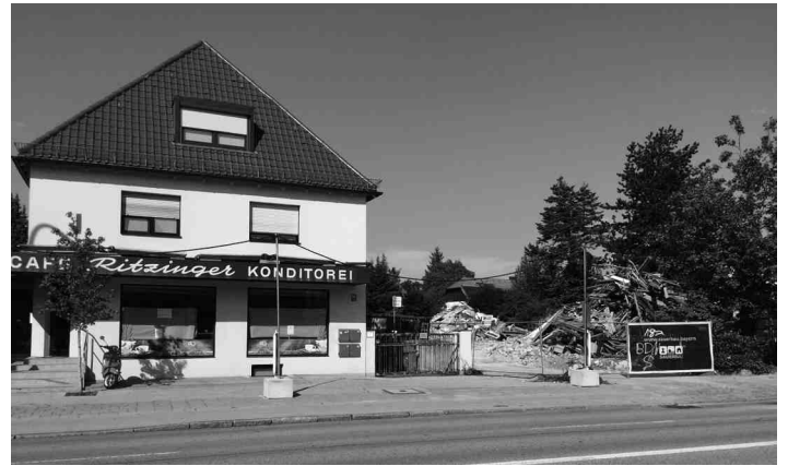
Stetiger Wandel in der Verdistrasse: Das Café Ritzinger wartet auf einen neuen Betreiber. Neben an wurden die vormaligen Einzelhandelsgebäude mittlerweile abgerissen. Foto: Thomas Hasselwander
