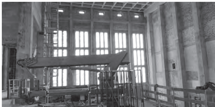
Die ehemalige Kesselhalle, der Hauptraum des neuen Kulturortes, beeindruckt durch ihre Ausmaße. Hier im Bild während der Bauzeit am 25. Juni 2022. Foto: Frieder Vogelsgesang
