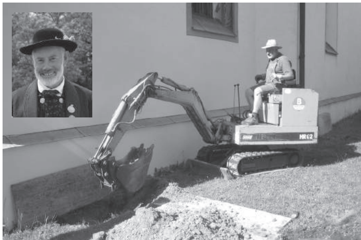
Josef Kinast bei Schürfarbeiten im Vorfeld der Sanierung von St. Wolfgang am 29. Juni 2006.
